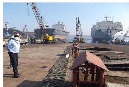
適正に管理された解体施設
