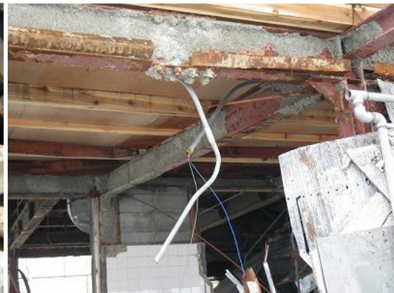
残存した吹付け材
