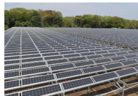
太陽光発電システム
