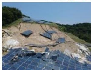
土砂崩れで生じた崩落
