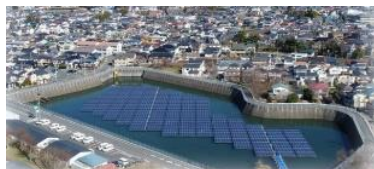
水上太陽光発電（埼玉県所沢市）
