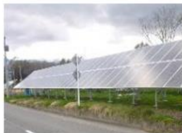
柵塀の設置されない設備
