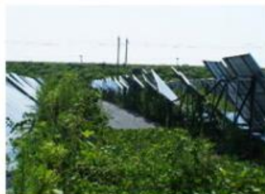
不十分な管理で放置されたパネル
