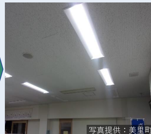
<蓄電池使用時>
