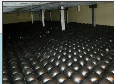
冷水蓄熱槽（水面被覆材）
