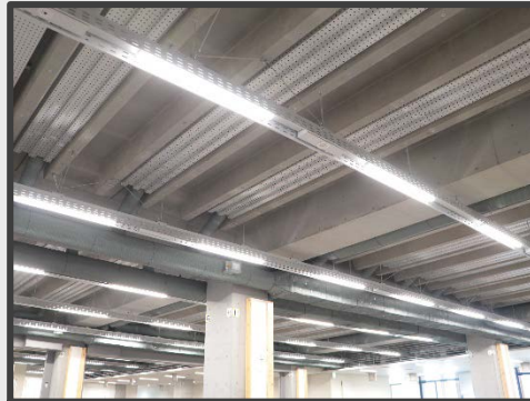
LED照明・空調吹出口
