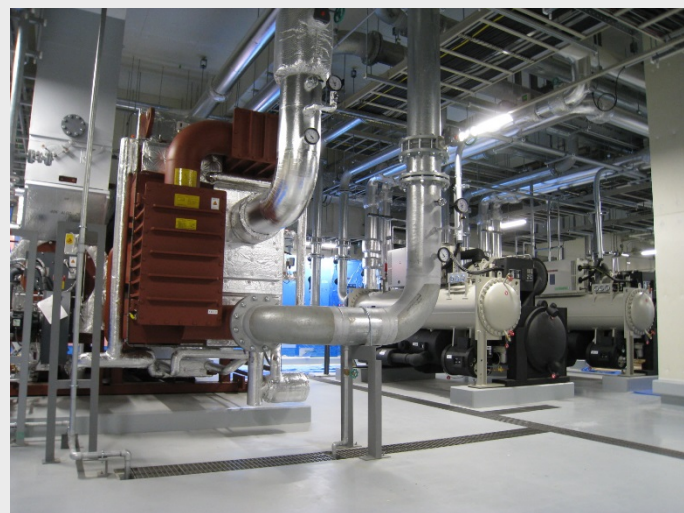
吸収式冷温水機・ターボ冷凍機
