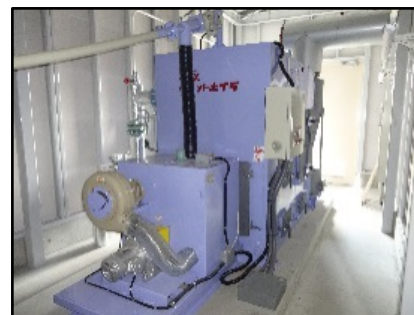
バイオマスボイラー
