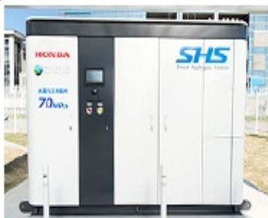
水素ステーション
