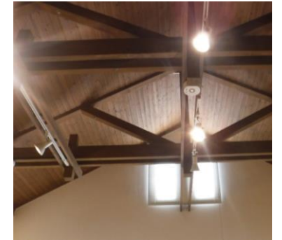
石狩浜海浜植物保護センター LED照明
