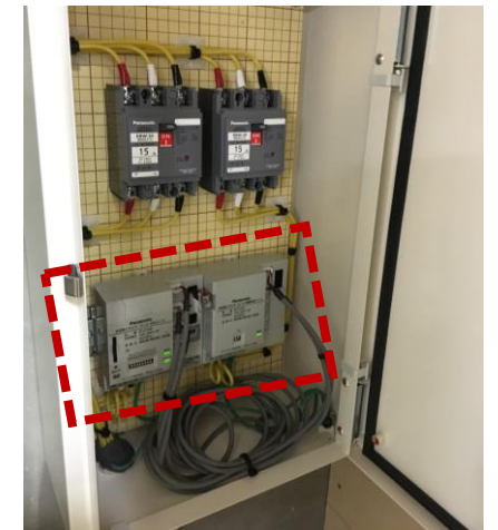
分電盤に設置した電力量計
