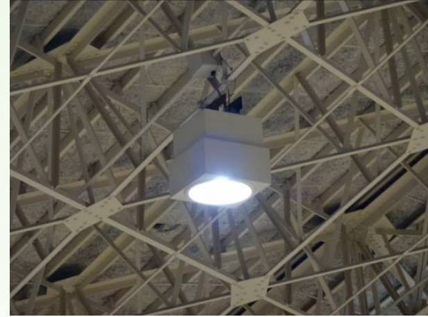
体育館での照明設備（水銀灯）
