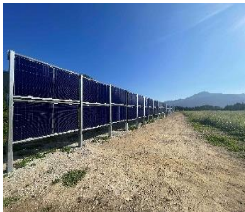
牧草地におけるソーラーシェアリング
