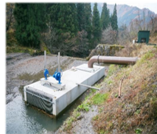
小水力発電施設
