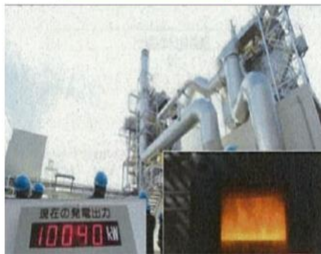
稼働中の木質バイオマス発電施設
