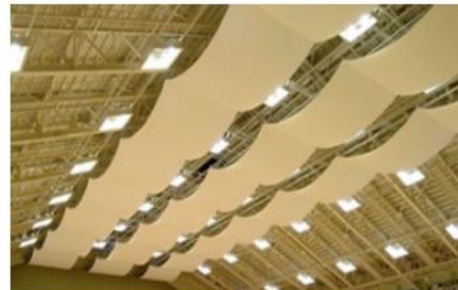
LEDを導入した体育館内アリーナの高天井
