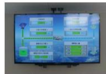
発電情報モニターを設置
