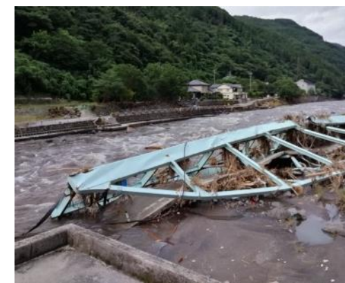
令和2年7月豪雨 大分県日田市の流された橋
