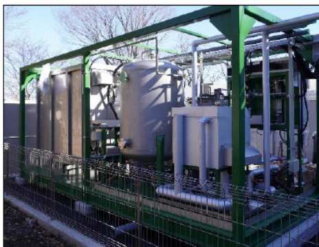
メタン発酵バイオガス発電設備
