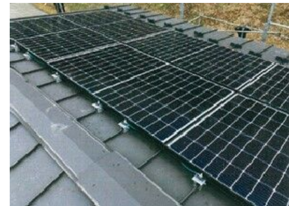
※太陽光発電設備設置状況
