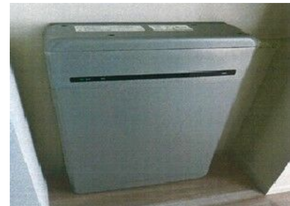
※蓄電池設置状況
