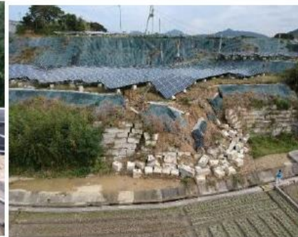
法面保護工が崩れて流出した事例
