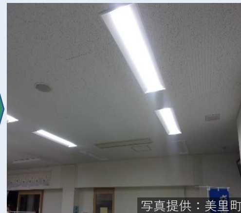
<蓄電池使用時>
