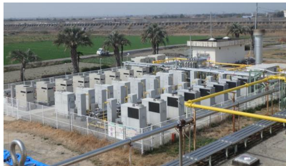
消化ガス発電 24台（既設16台・新設8台）
