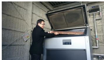
木質ボイラー
