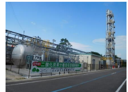
二酸化炭素分離回収設備
