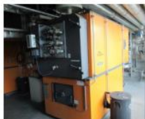
本庁舎の バイオマスボイラー
