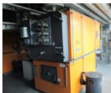
本庁舎の バイオマスボイラー
