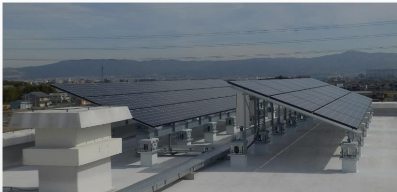
県有施設への太陽光パネル設置
