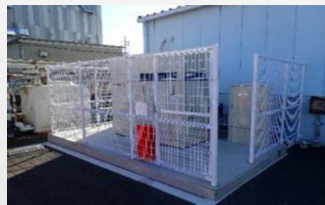
ガスコージェネレーションシステムの導入 （化学工場）
