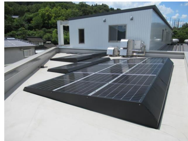
太陽光発電設備 (PPA)
