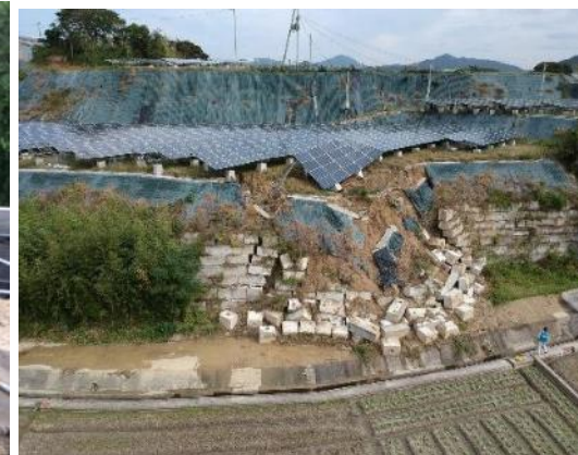
法面保護工が崩れて流出した事例
