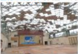
台風で屋根が消失した体育館
