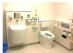
バリアフリートイレの整備
