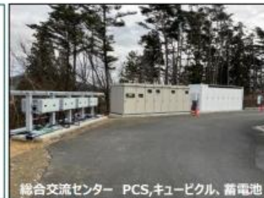
総合交流センター PCS, キュービクル, 蓄電池
