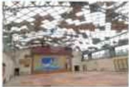
台風で屋根が消失した体育館
