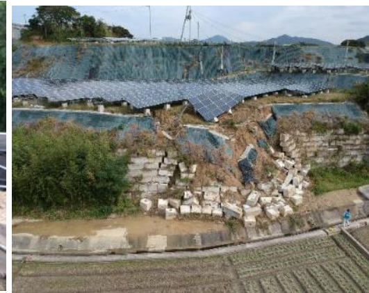
法面保護工が崩れて流出した事例
