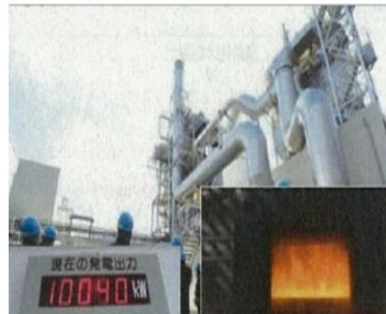
稼働中の木質バイオマス発電施設
