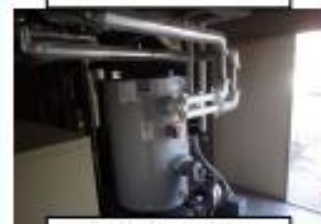
BUボイラ (灯油) ※補助対象外
