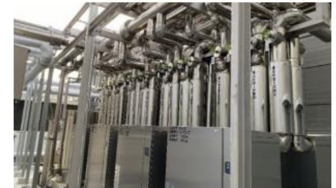
導入したヒートポンプ
