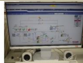
VWV制御 (空調機の冷温水流量を負荷に応じて調整)
