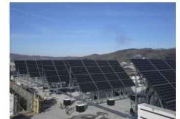
同時導入された太陽光発電設備
