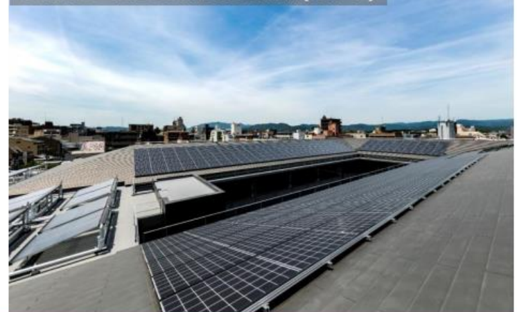
事業所の屋根置き太陽光発電設備(京都市)
