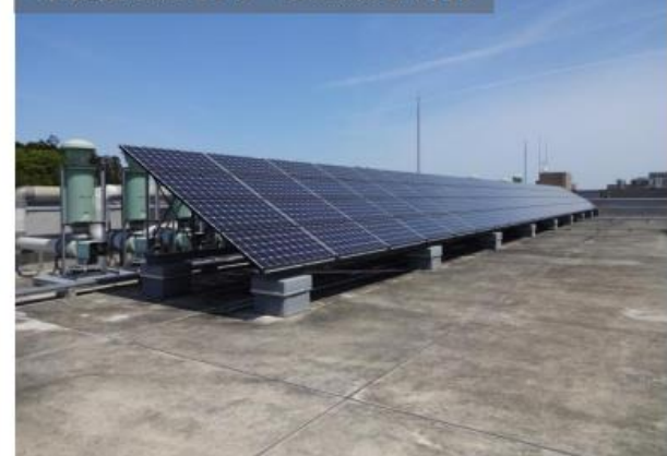
県保健環境センターの太陽光パネル
