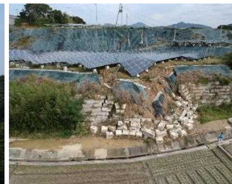
法面保護工が崩れて流出した事例
