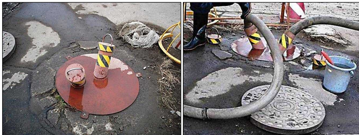
写真 4.2.4.1 し尿・浄化槽汚泥の投入口(左)と投入時の様子(右)
