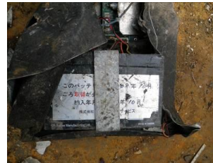
鉛バッテリー (UPS)
