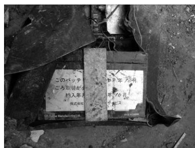
図 3.1.51 UPS(?) (バッテリー付属)
