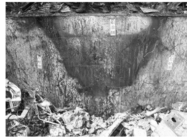
図 3.1.16 船倉の変色状況
