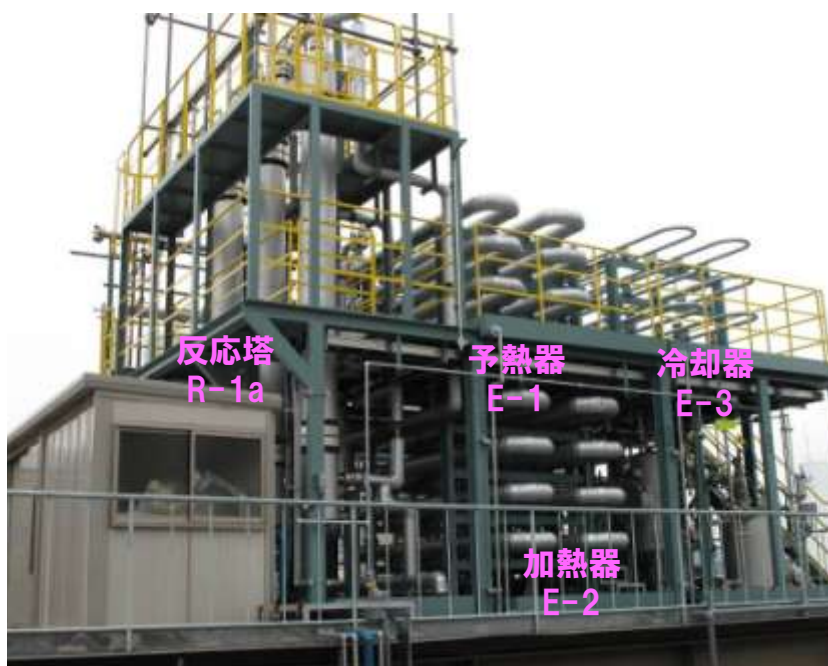
図 2：パイロットプラント外観
