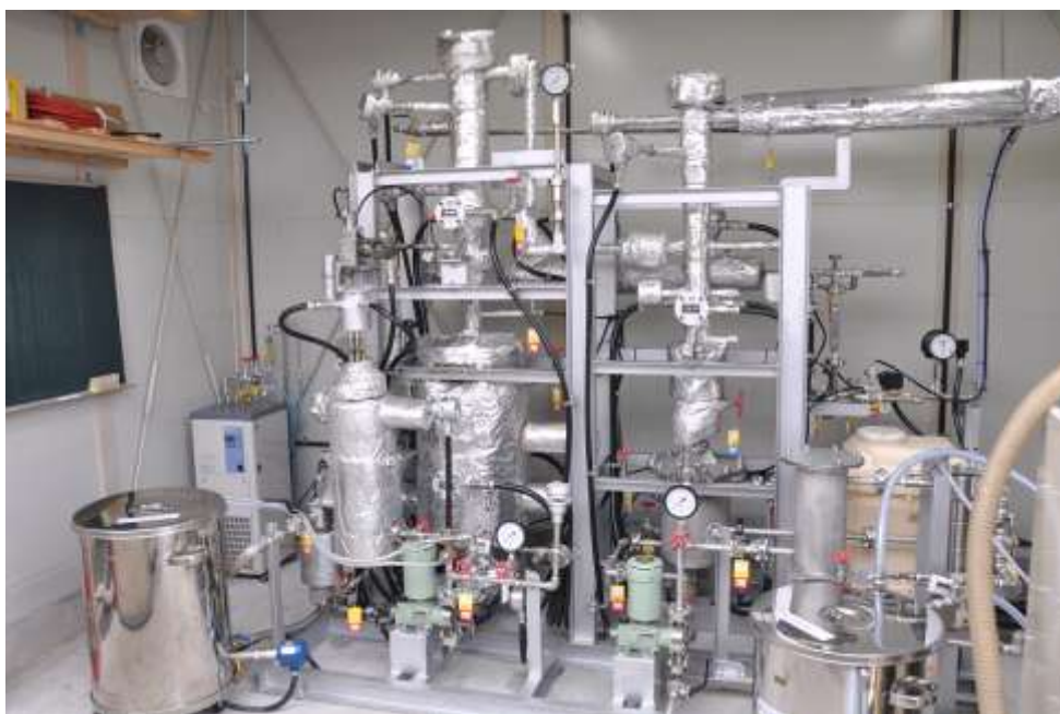
図 6 実証設備外観(反応器ユニット)
