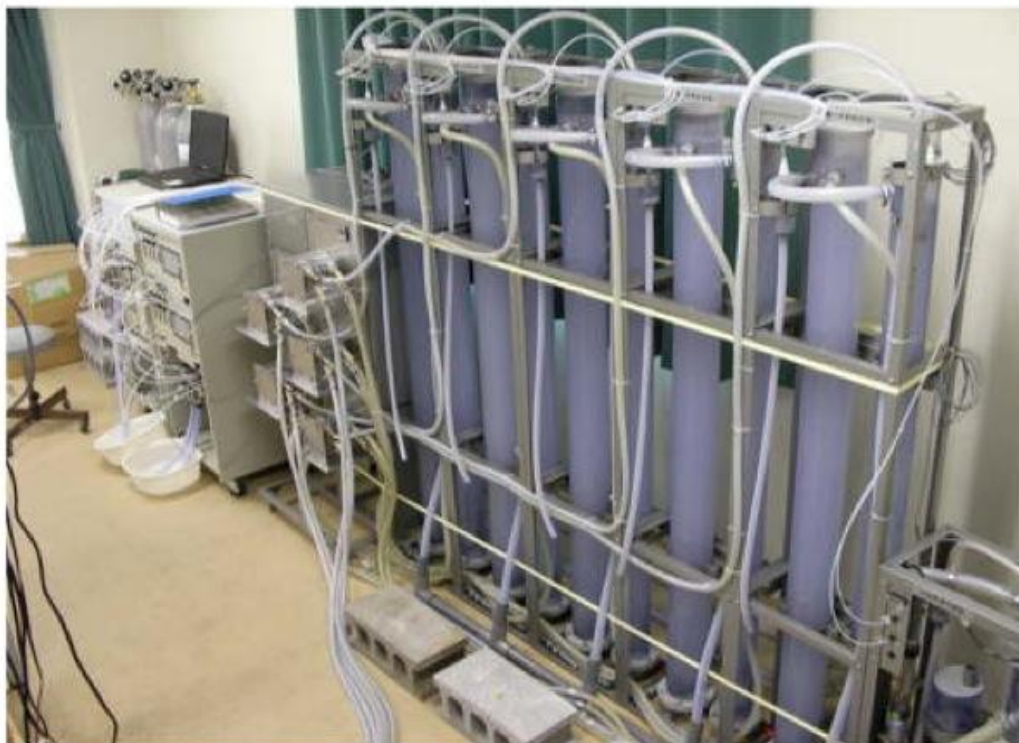
図2 瀬底実験施設に設置された精密pCO 2 制御装置の写真
