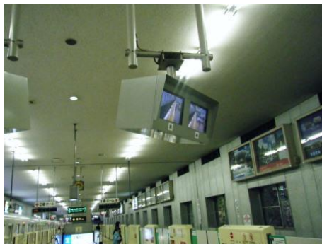
図 1.6 地下鉄駅ホームに設置されているブラウン管式モニター（札幌市）
