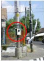
道路照明省エネ
