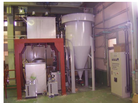
排水処理設備
