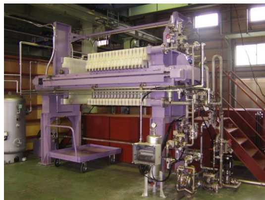
脱水・洗浄用フィルタプレス
