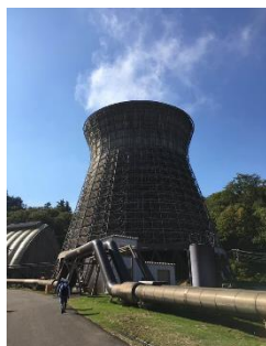
▲松川地熱発電所
