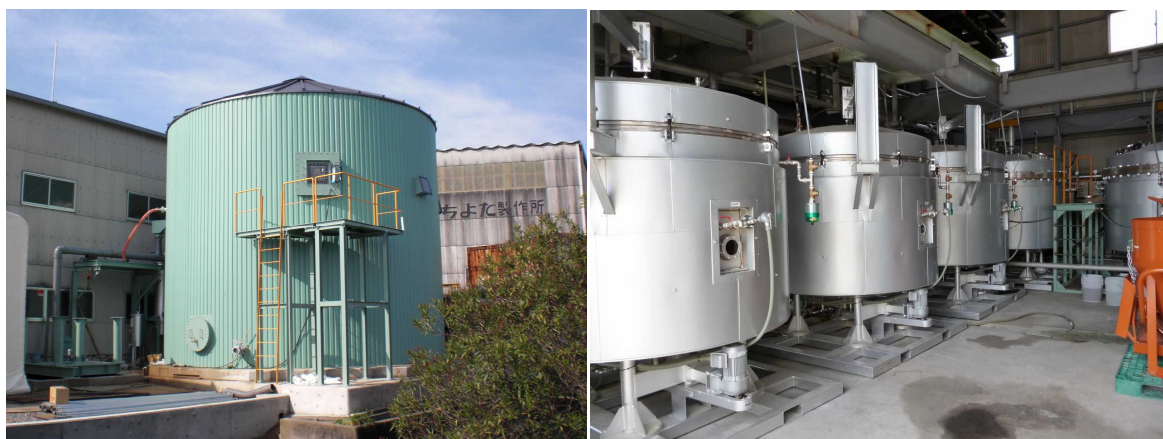
図 3-60 メタン発酵槽（左）とバイオエタノール製造装置（右） 出所）（株）ちよだ製作所
