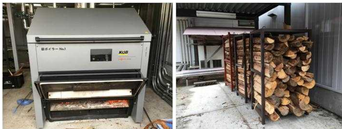
図 3-58 ボイラーおよび薪 出所) 村楽エナジー (株)
