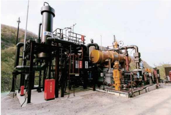
バイナリー式地熱発電所
