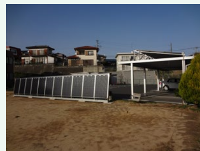
写真2-3-11 日立市田尻交流センターにおける設置状況
