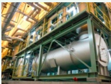
写真 2-2-6 福島市堀河町終末処理場： 下水污泥減容化事業
