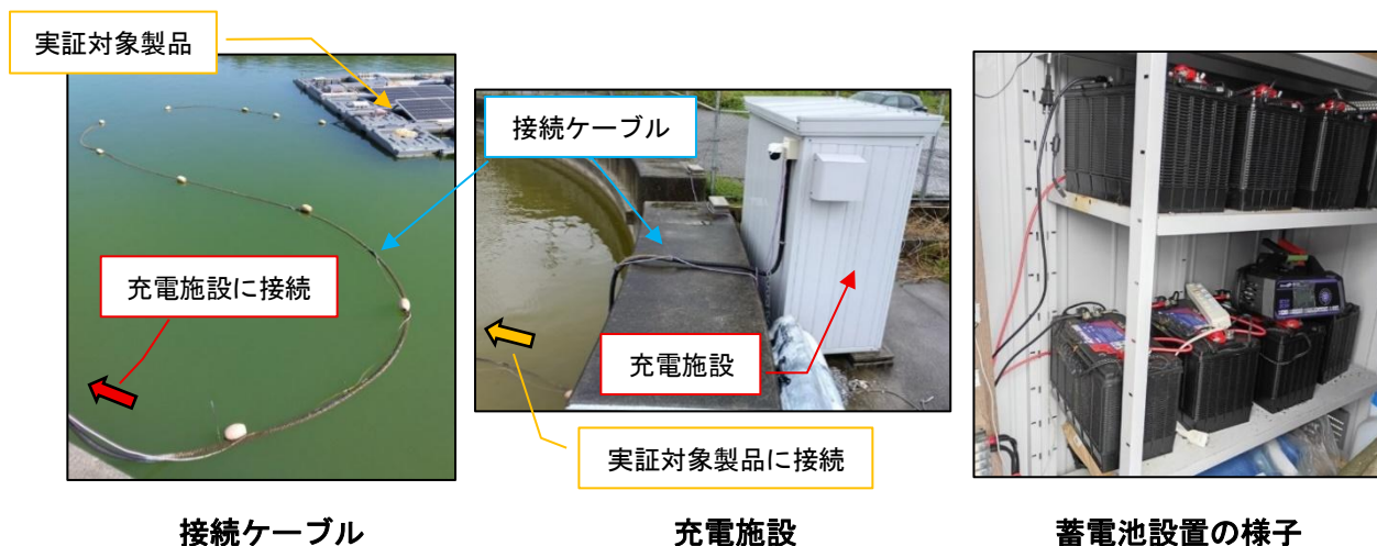
図3-7 充電施設等の写真
