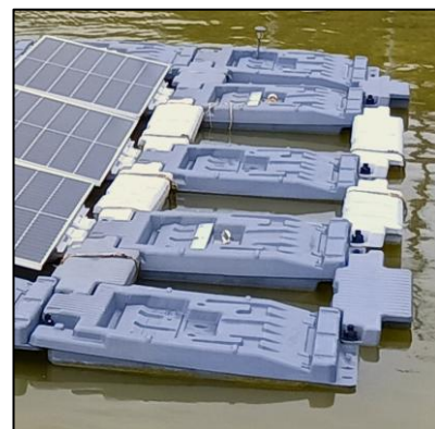
水上フロートと通路ジョイント
