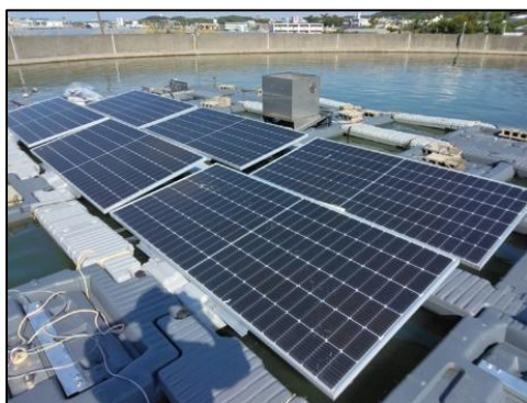
太陽光パネル
