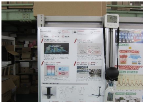
倉庫 A 内に簡易温湿度計併設
