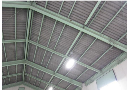
倉庫 B の断熱施工無しの状況
