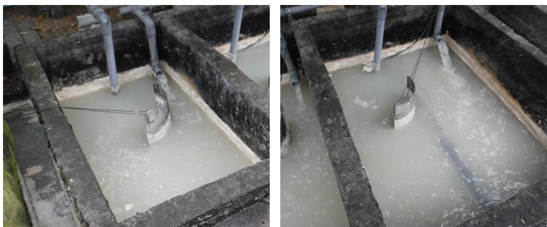
写真2 実証対象製品稼働時（導入後）の油水分離槽
