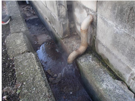
図 11 ドレンタンクブロー状態(エコモルダ―停止)フラッシュ蒸気発生状況
