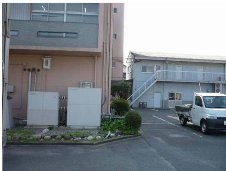
写真3 室外機(水冷ヒートポンプ)(左側)と地下水熱交換ユニット(右側)
