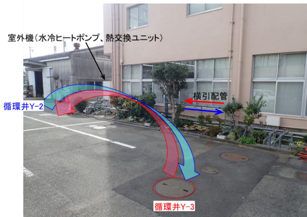
写真1 循環井Y-2、Y-3、室外機等の設置状況
