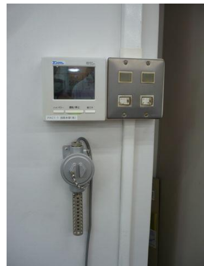
写真7 ヒートポンプリモコン、室内温度センサー
