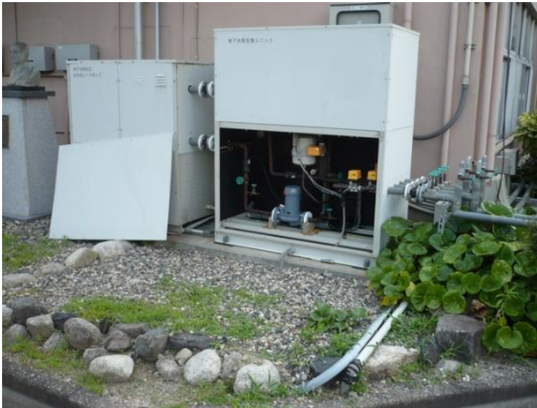
写真4 地下水熱交換ユニットとその内部
