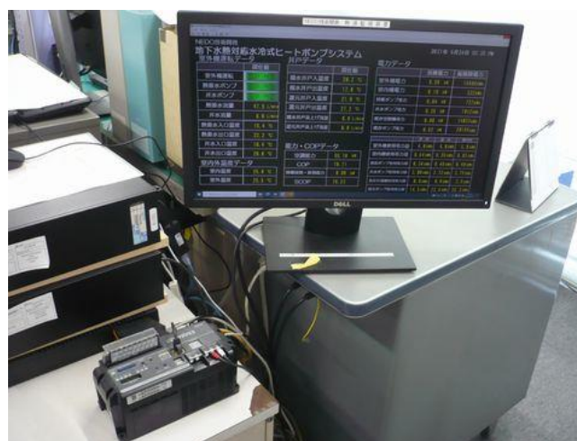
写真8 熱源監視システム（モニター）
