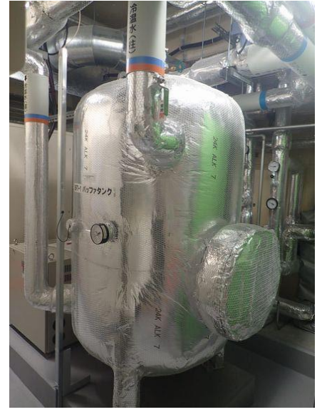
写真9 BFT-1 バッファタンク
