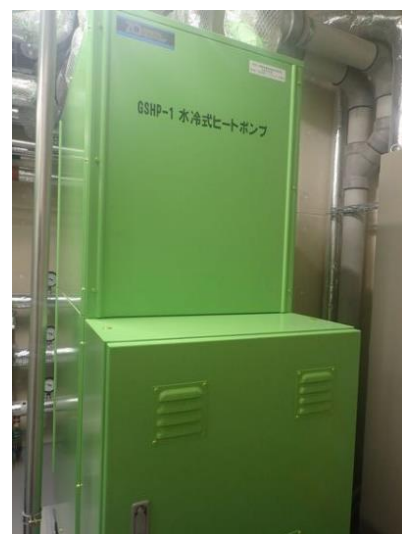
写真2 ヒートポンプ
