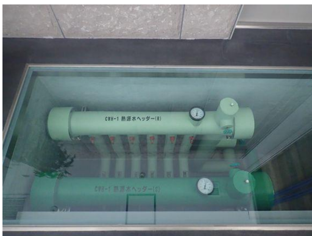
写真5 1次側熱媒ヘッダー
