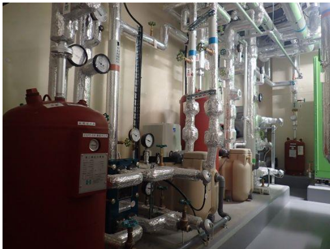
写真10 1階機械室、配管
