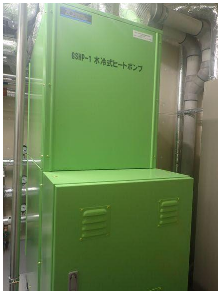
写真7 地中熱ヒートポンプ
