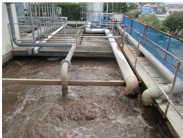
活性汚泥槽の状況
