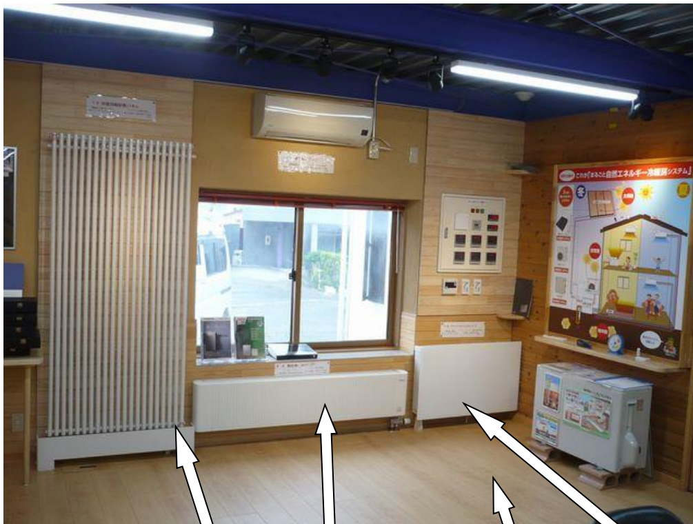
写真 3 室内機の全景
